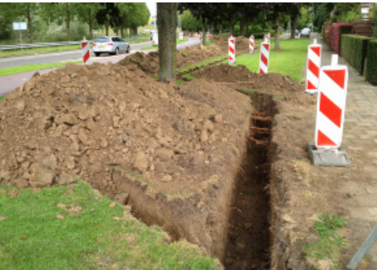
Werkzaamheden aan kabels en leidingen vormen een dagelijkse bedreiging voor veel bomen. Steeds vaker worden deze schades door de boombeheerder verhaald.
